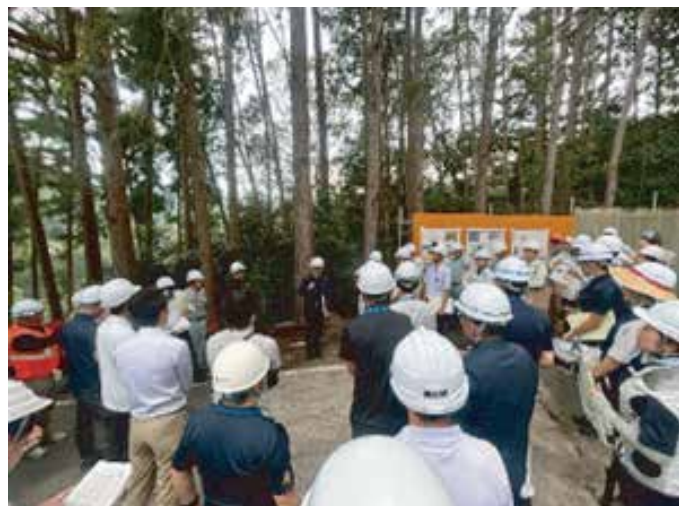
長沢地すべり 現場説明状況
